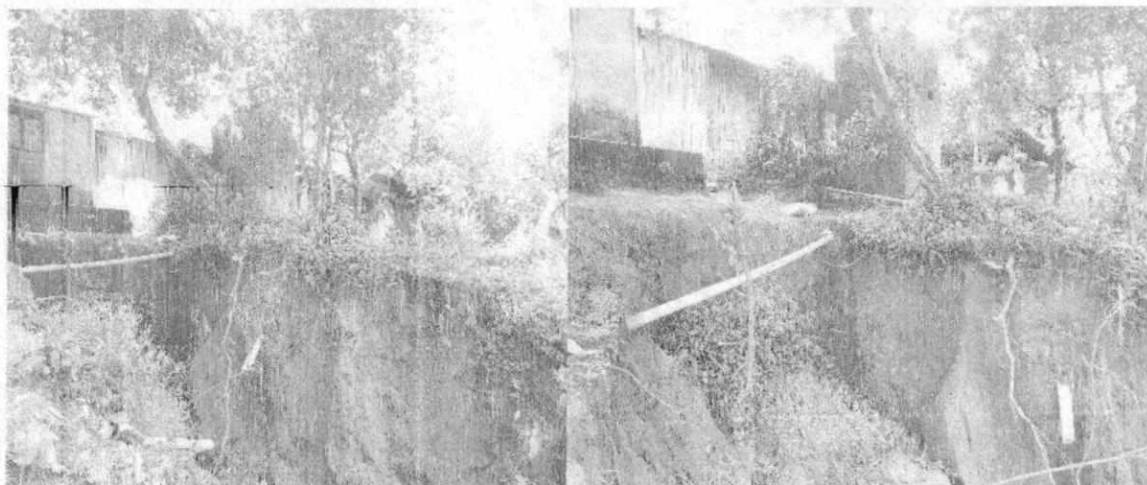
Cárcava en la parte posterior de Institución Educativa Alto Sano, Centro de Salud y vivienda.
