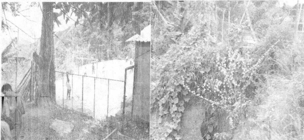
Polideportivo y socavón parte posterior.
